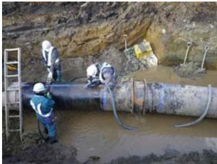
送水管の破損
