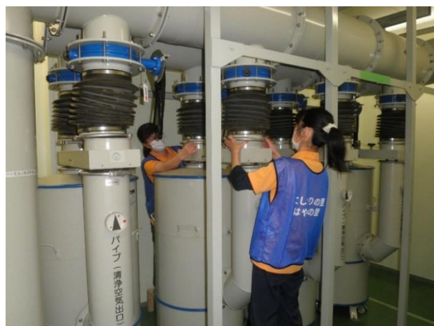
フィルタリングシステムの起動
