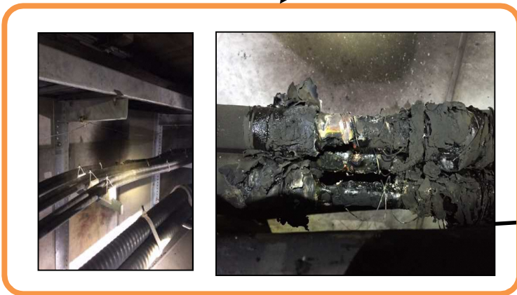
<洞道内ケーブル損傷箇所>
