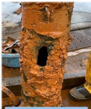
水を吸い上げる 管の腐食
