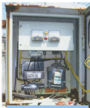
制御盤の漏電
