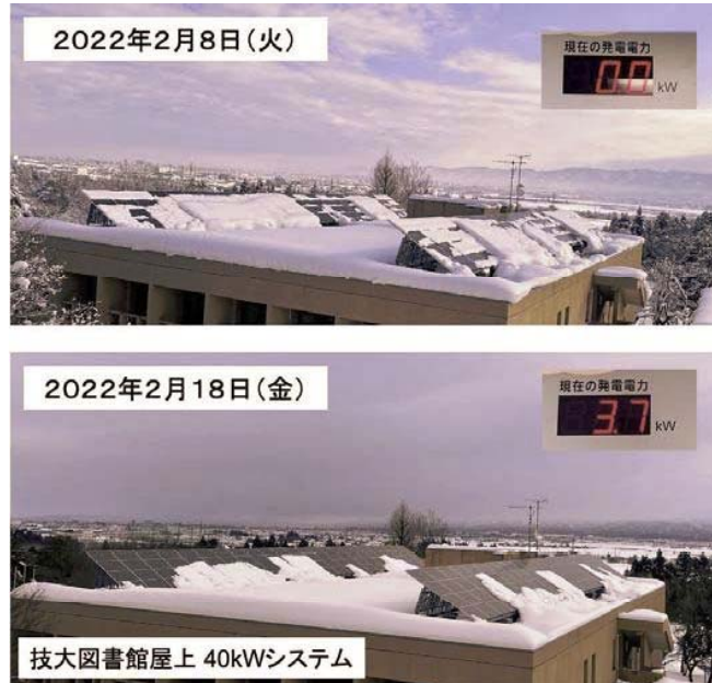
図6 従来型傾斜架台システムの冠雪状況
