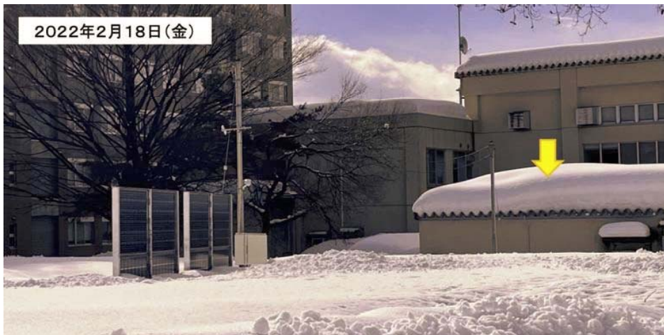
図4 積雪 110cmでの実証実験システムの様子 (黄色矢印の屋根面に耐荷重パネルが搭載されている)
