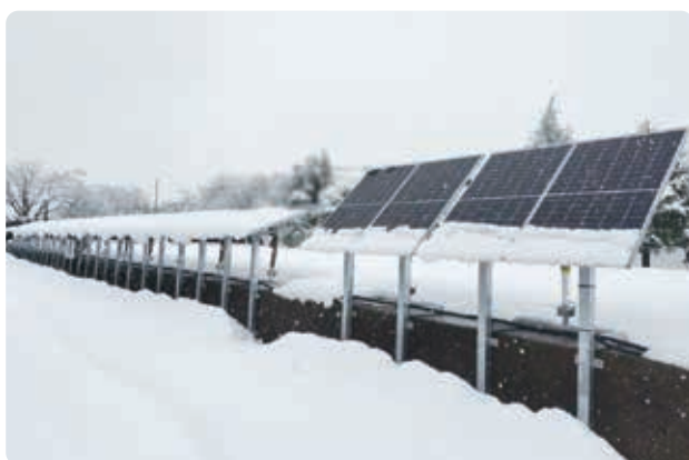
長岡中央浄化センターに設置した角度可変型架台。雪の落ちやすい角度を確認しています。
