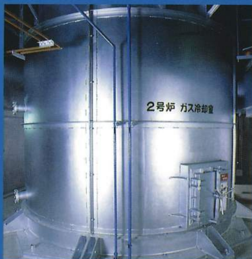
■ガス冷却室 ごみを燃やしたときに出る燃焼排ガスが高温のため、冷却して温度を調節します。
