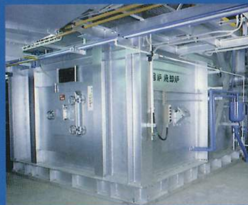
■焼却炉 炉内へ入ったごみは、800~950℃の高温で燃焼し、ごみの臭気成分さえも熱分解されます。
