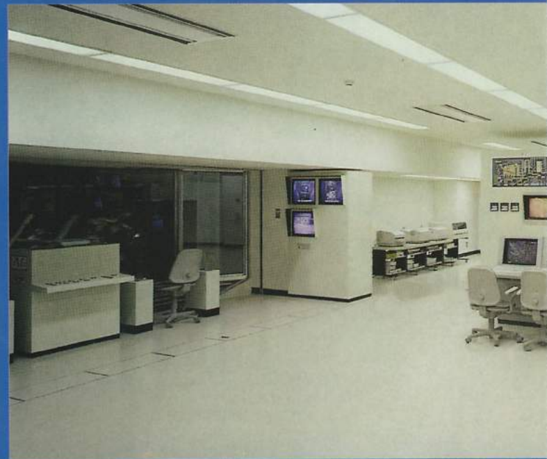
■中央制御室 焼却炉の運転、ごみクレーン操作、公害対策機器の監視・制御などすべての運転操作・管理が行われています。
