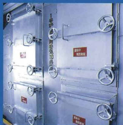
■高温水発生装置 ごみの焼却により発生する熱で温水温風を発生させ、その温風により高温水を造ります。
