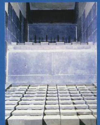
■焼却炉内部 炉内へ高温の空気を送りこんで、ごみを完全に焼却します。
