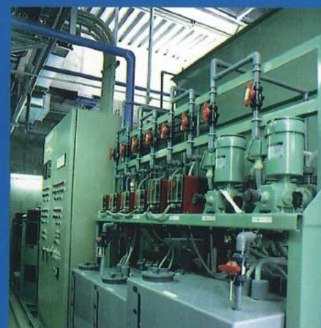
■排水処理装置 灰汚水、床洗浄排水などの汚水は排水処理装置で処理後、ガス冷却用水として再利用します。
