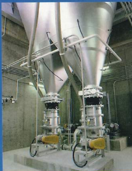
■有害ガス除去装置 排ガスに含まれている塩化水素を消石灰の噴射により効率よく反応させて除去します。
