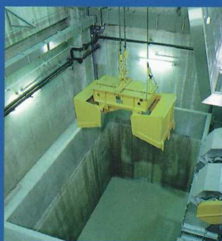
■灰クレーン・灰ピット 焼却灰は一旦灰ピットに貯留され、灰クレーンによりトラックで搬出されます。
