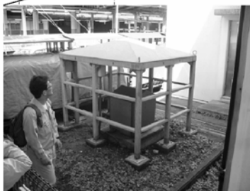
エレベーター設置検討箇所に設けられている地震計。移設可能性についてJRと協議が必要。
