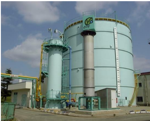
長岡中央浄化センター 消化ガス有効利用施設
