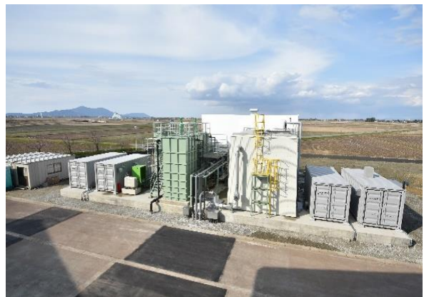
中之島浄化センター 実証研究施設
