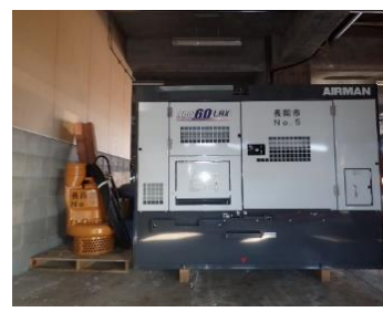
可搬式ポンプ・発電機の常備
