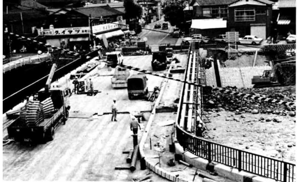
急ピッチで工事が行われている刈谷田橋 (金沢側から本町方向に向って撮影)
