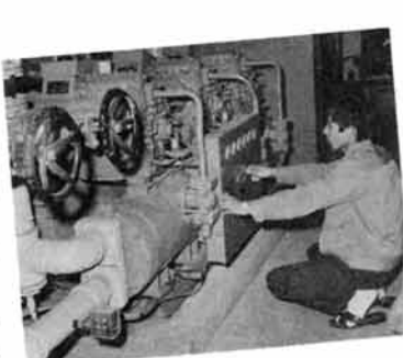
大ホールは60キロ冷凍トンで冷房
