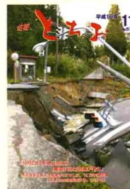
▶574号(H16.11.5) 中越震災により崩壊した国道351号(本津川地内)。復興に向け「がんばろう栃尾！」
