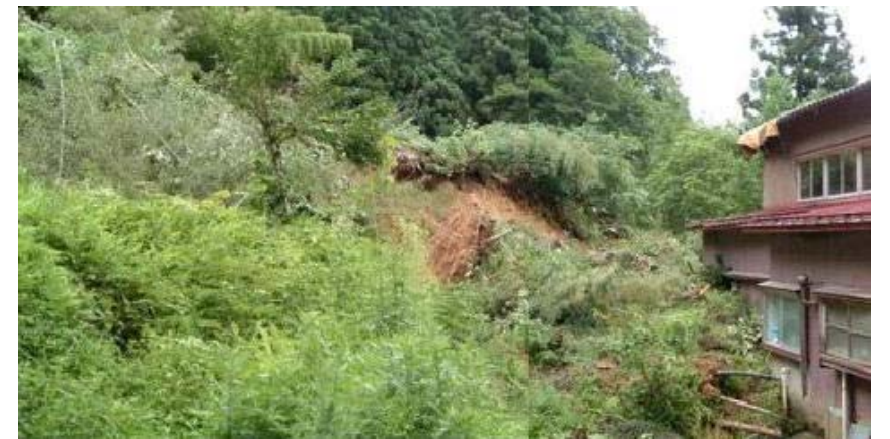
配水管が全損した泉地内の市道崩落現場。赤坂配水池から宮沢・泉に給水して急場をしのぎ、別ルートの古い配水管を利用して仮設工事を行い給水を確保しています
