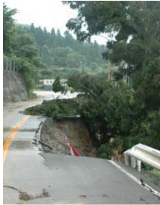
道路下の稚児清水川まで崩れ落ちた県道栃尾田井線(小貫地内)
