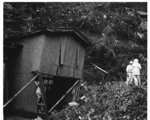
泉地内の地すべり(平成7年)
