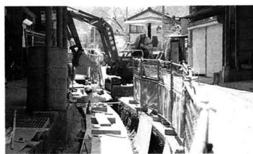
流雪溝の改良にも力を注ぎます。
