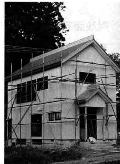
最終仕上げ工事中の松尾集会所。工期は11月18日。(県の補助金を活用)
