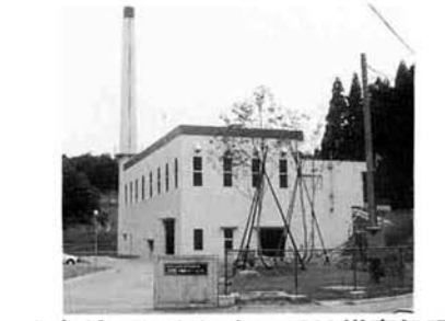
▲クリーンセンターでは煤塵処理 施設整備工事が行われます
