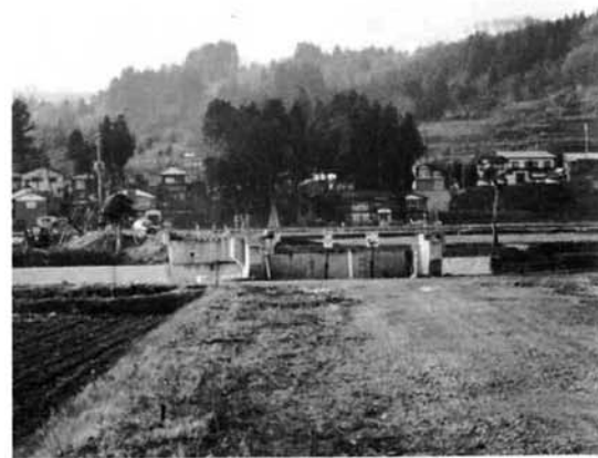
▲来秋には、塚山小国線のバイパス的機能を発揮する工事中の渋海新橋
