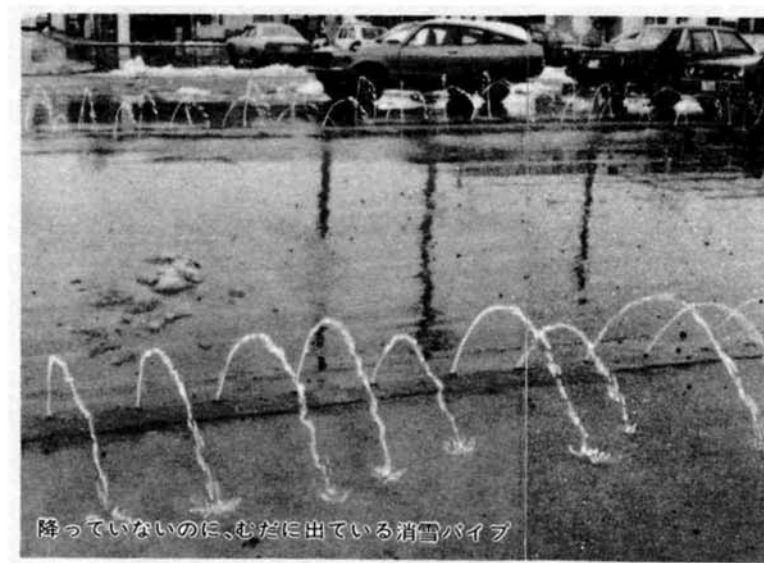
降っていないのに、むだに出ている消費パイプ
