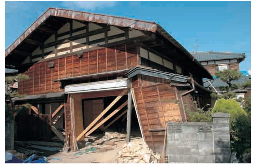
▲大きく傾いた家屋(寺泊地域)
