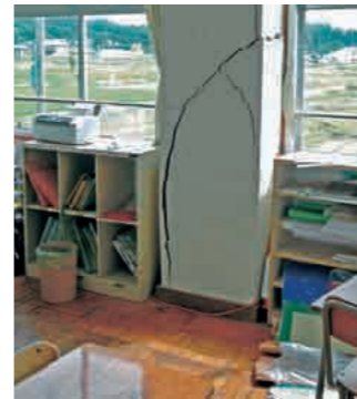
▲教室の柱に大きな亀裂がはいった下小国小学校
