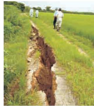
▲農地にも大きな地割れが発生(寺泊地域)
