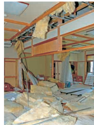
▲天井が落下した大積コミュニティセンター
