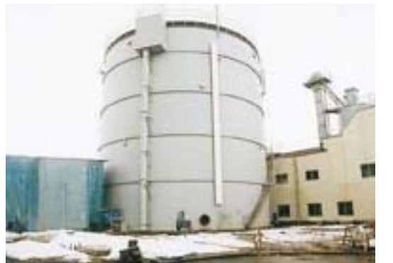
長岡中央浄化センターのガスホルダー
