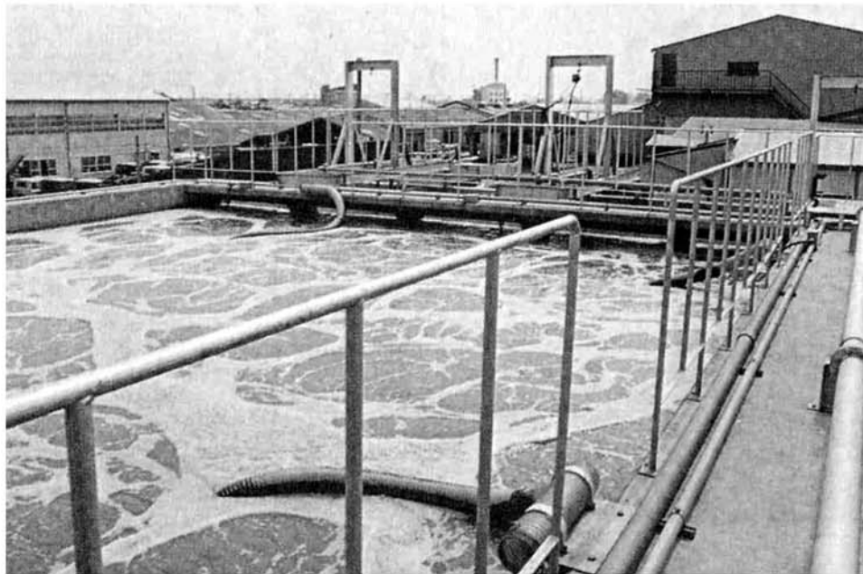
活性汚泥法による除害施設
