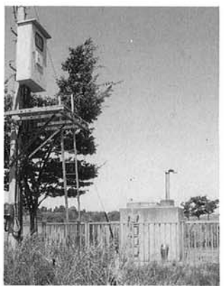
浦地内の取水井
