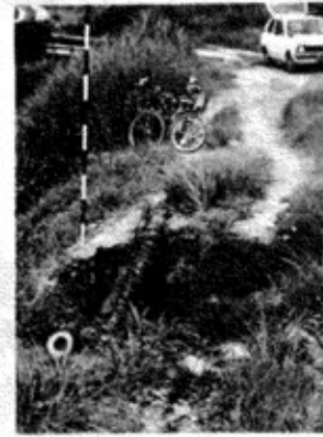
▲ 欠壊した道路
