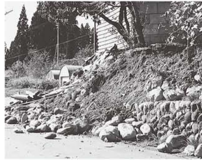
地震により崩れた石垣
