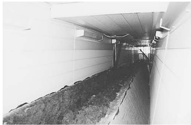
▲真二つに裂けた越後川口駅地下通路
