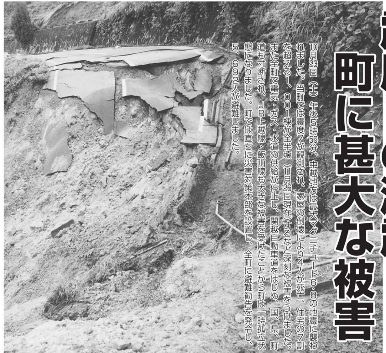
▲道路決壊 (県道小千谷川口大和線、牛ヶ首)
