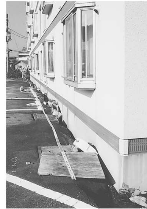
基礎部分が沈んだしみず団地1号棟
