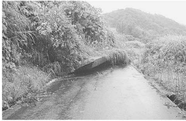
▲木沢 町道日カゲ線でブロック倒壊
